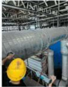
喷砂、涂装废气排放口
