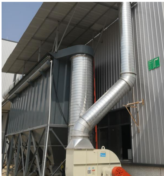
破碎筛分废气排气筒
