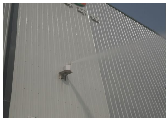
车间外喷雾降尘设施
