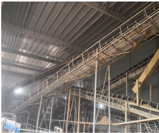
封闭车间内物料传输带
