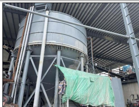
污水处理沉淀罐
