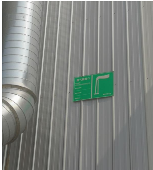
废气排放口标识牌
