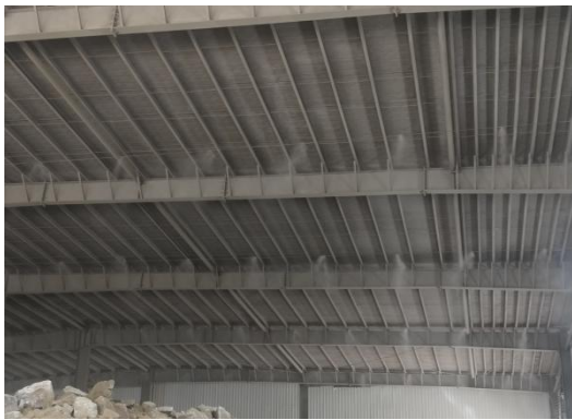
原料车间内喷雾降尘设施
