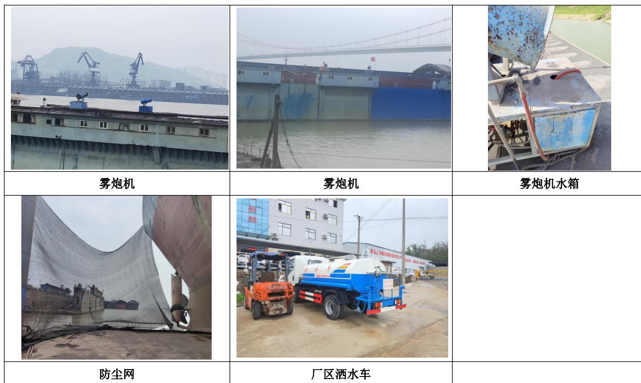
图 4-1-3 项目废气处理设施图片
